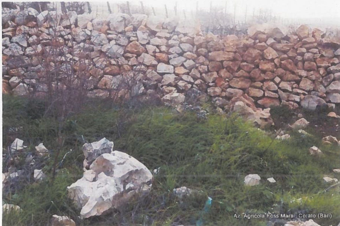
Passaggi e danneggiamenti da cinghiale ai muretti in pietra
